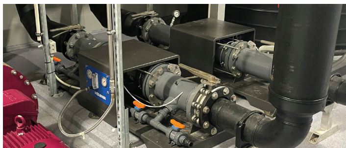
Figura 1. Instalación de generadores de nanoburbujas Moleaer Trinity L2 para la oxigenación principal en la instalación RAS de Lødingen Fisk. Las unidades L2 Trinity tienen una capacidad de flujo de líquido de 230 m 3 /h (1000 galones por minuto) cada una y una tasa de inyección de oxígeno de 5 a 50 SLPM. Se instalaron recirculando el agua del biofiltro hacia los tanques de cabecera.
